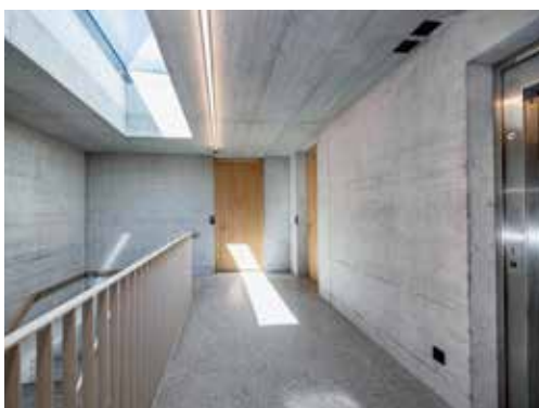
Die Treppenhäuser sind grosszügig und hell. Der Broggepark ist mit dem LEA-Label für hindernisfreies und altersgerechtes Wohnen zertifiziert.
